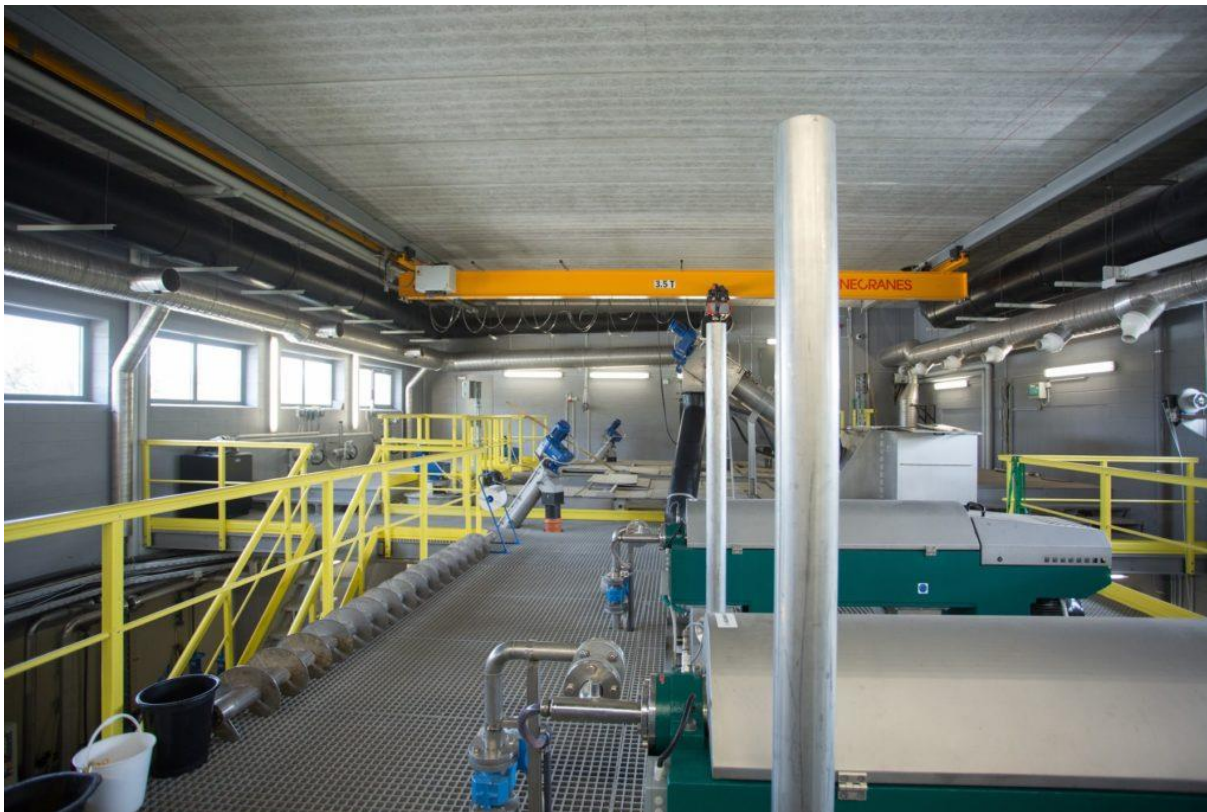
Foto 5-5 Puhasti tsentrifuugid mudatahenduseks, tagaplaanil automaativõre
