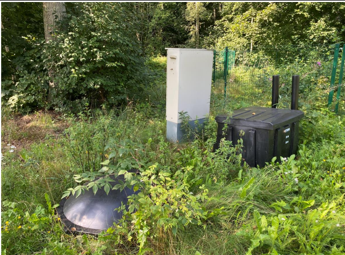
Foto 5-6 Prangli reoveepuhasti välisvaade
